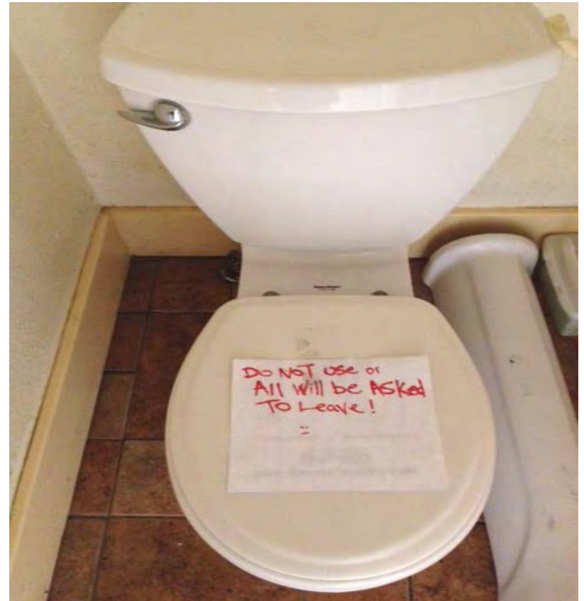
Non Functioning Bathroom
